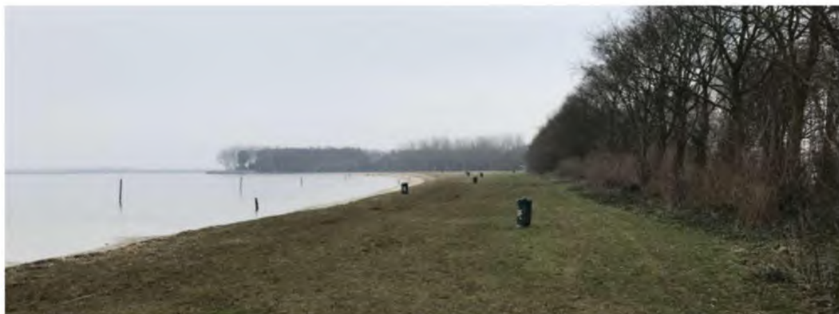
Verwaarlozing dankzij jarenlang achterstallig onderhoud door de gemeente Blaricum
