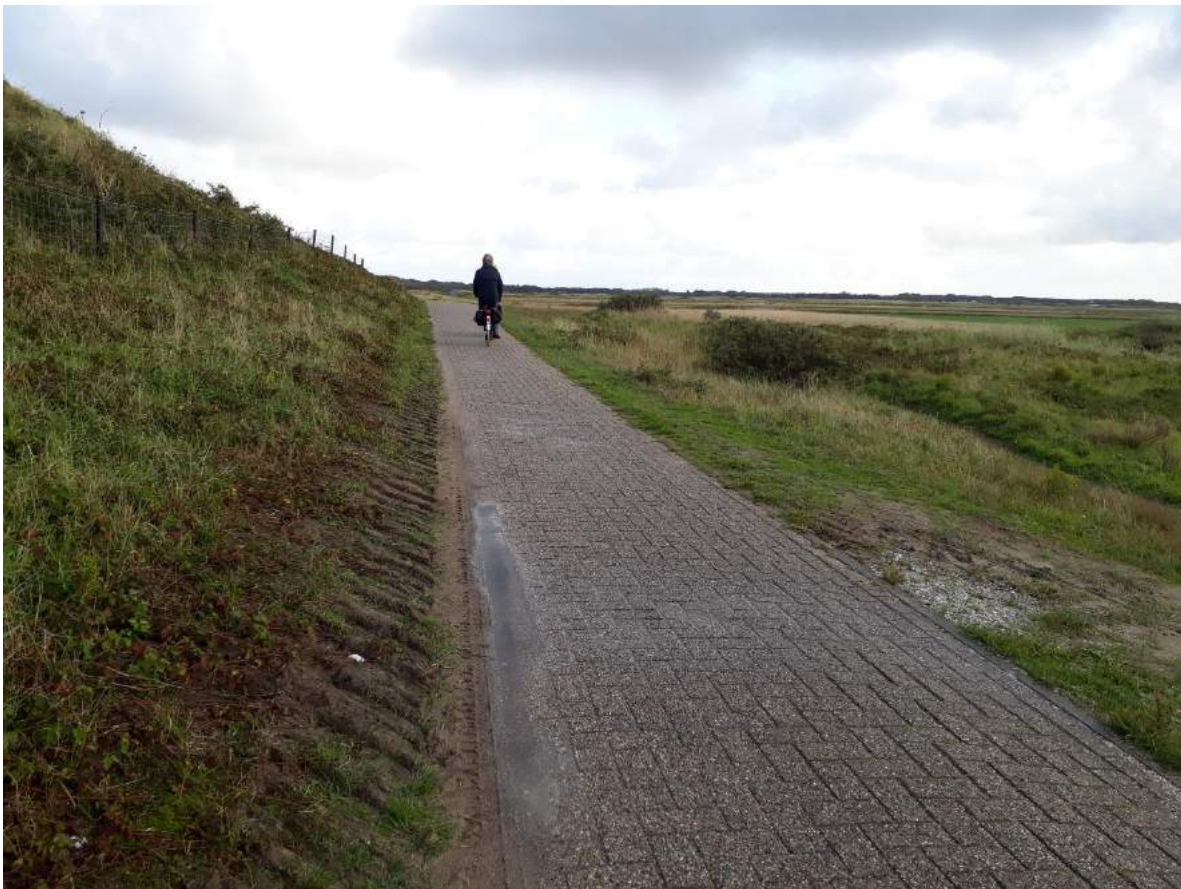
Een deel van het asfalt is al vervangen door een klinker verharding
