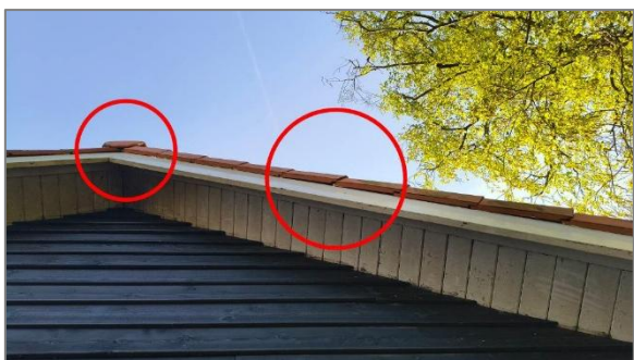
Afbeelding 5.3 | Openingen tussen kantpannen en nokpan.
