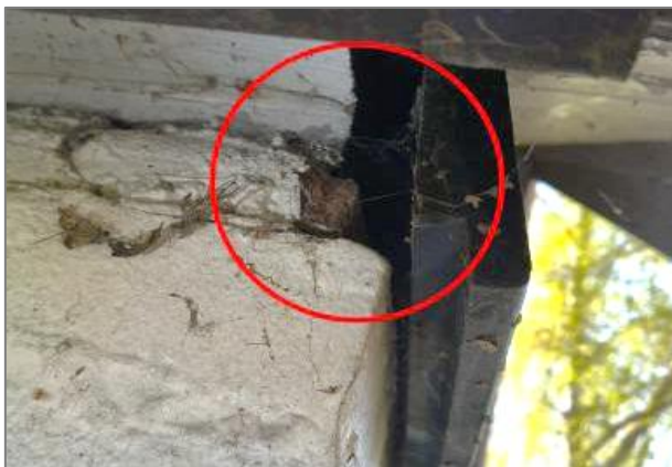
Afbeelding 5.2 | Bij elke hoek zit een opening tussen de muur en gevelbekleding.
