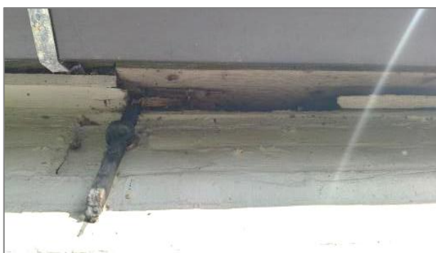
Afbeelding 5.1 | Opening in het houtwerk aan de zuidgevel.
